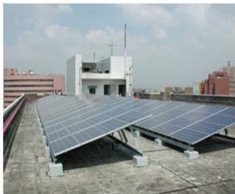
台電綜合研究所樹林所區 (20kWp 防災併聯型)
