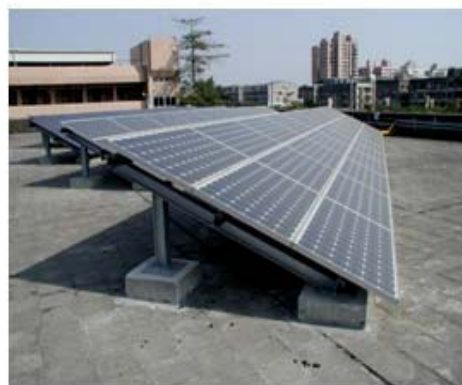
台電台北市區處(20kWp 併聯型)
