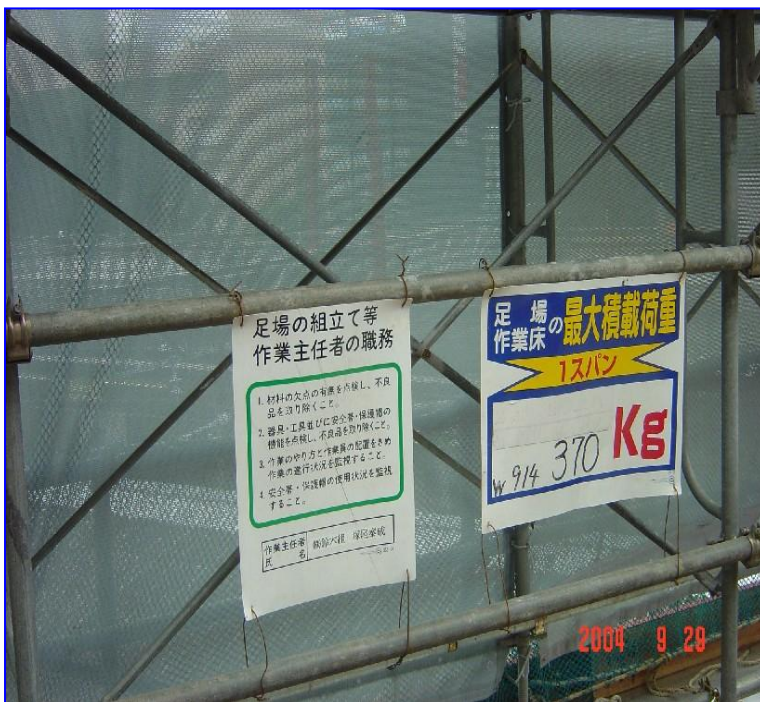
照片 9：施工架上之載重限制，應於明顯易見之處明確標示（以標示單一踏板載重限制為原則；另如經設計須標示整組施工架載重限制，則依須求增加標示該內容）。
