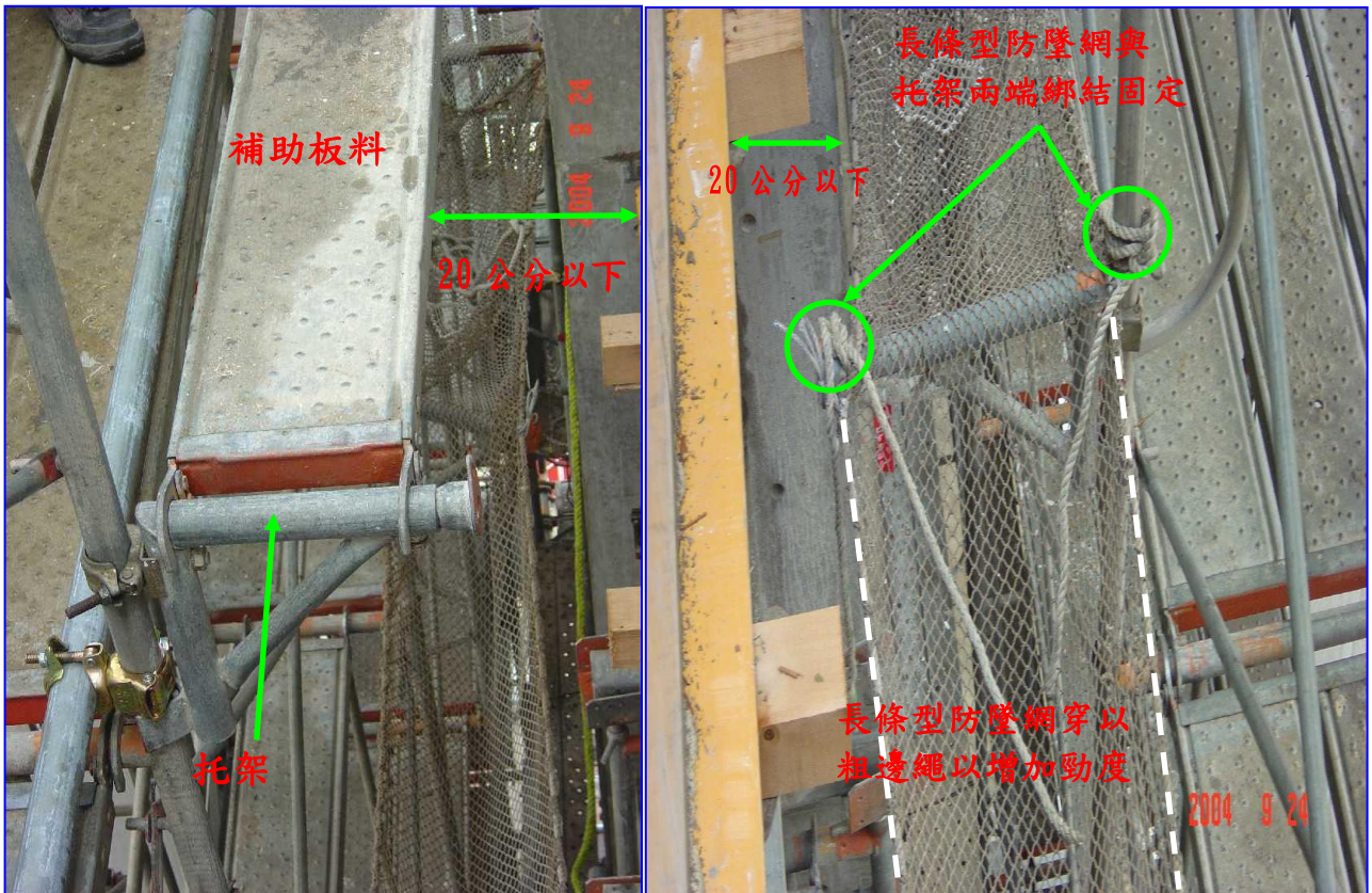
照片 5：外牆作業時，施工架與構造物間應使用托架鋪設補助踏板或長條型防墜網。
