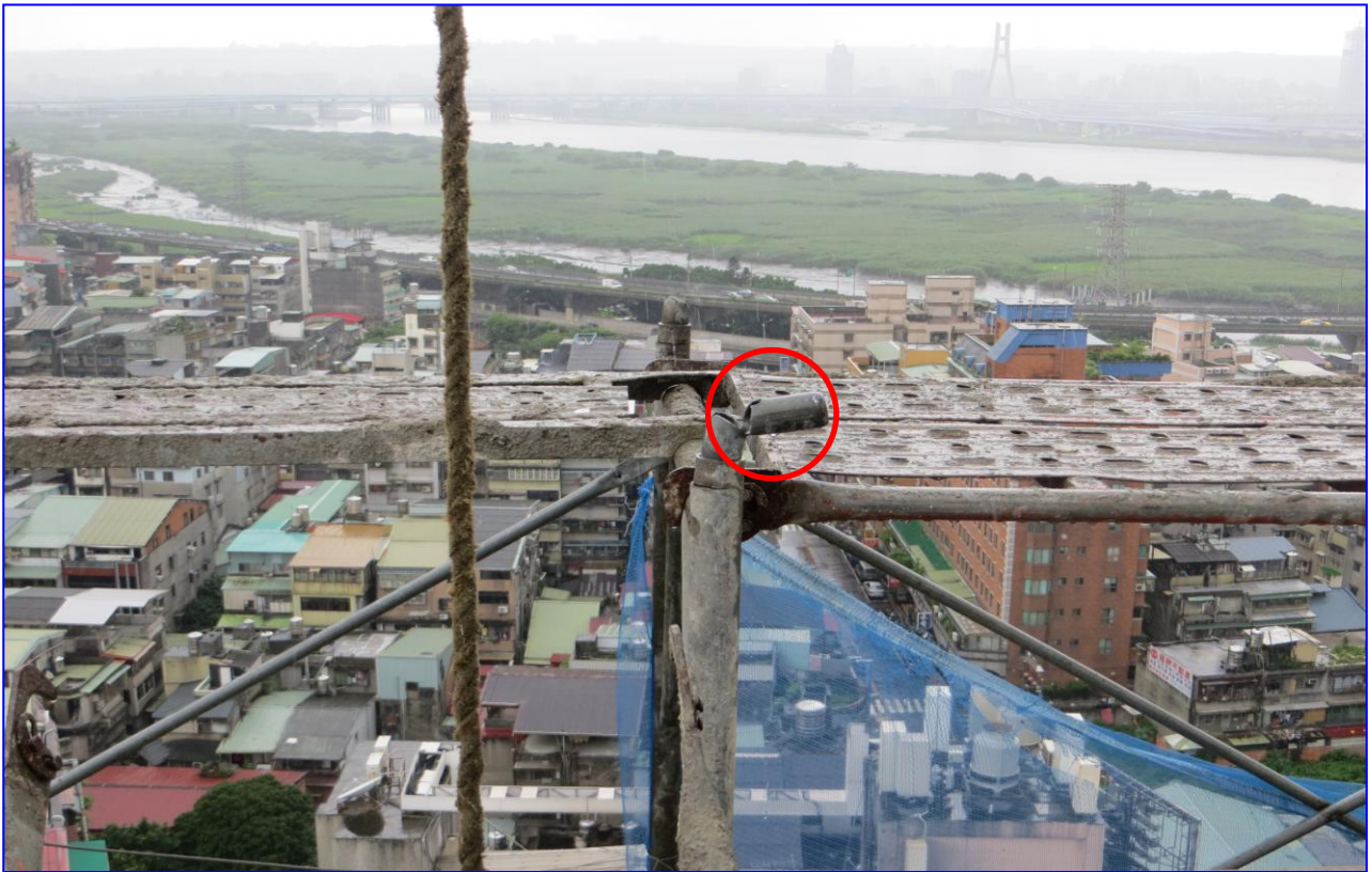
照片 14：未以機械吊運，使用繩索並以立架為支點，以人力吊運整捆交叉拉桿及下拉桿，人員隨倒塌之立架墜落（腳柱接頭斷裂）。
